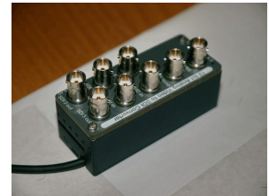
Dieses kleine Teil verursachte den Bildausfall
